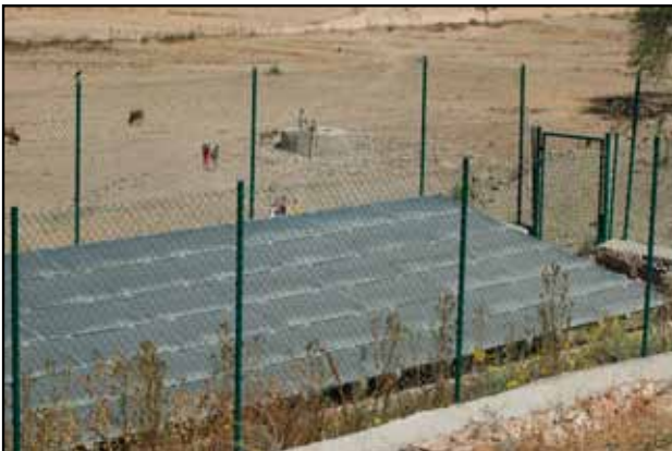
Solaranlage in Dekamhare
